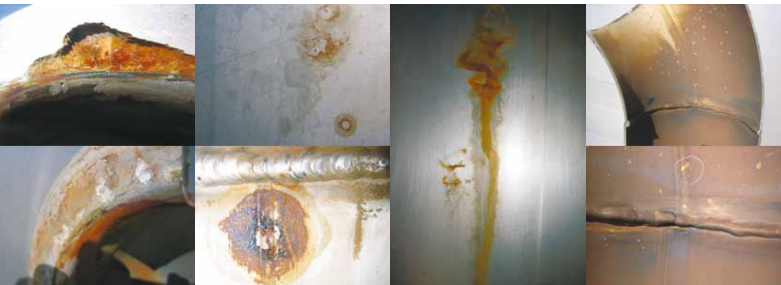
Längst till vänster syns exempel på spaltkorrosion, därefter tre exempel på punktkorrosion och till sist mikrobiologisk korrosion.
